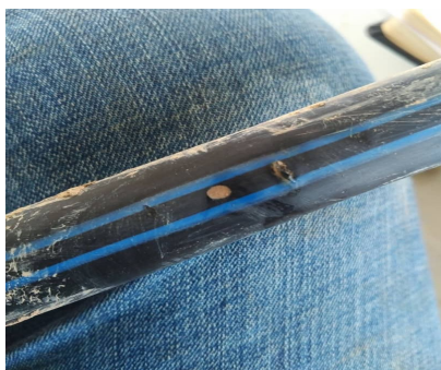
شکل 21- نمونه‌ای از مشکل صدمه دیدگی لوله آبدۀ در سامانه آبیاری قطره‌ای زیرسطحی (یوسف گمرکچی، 1399)
