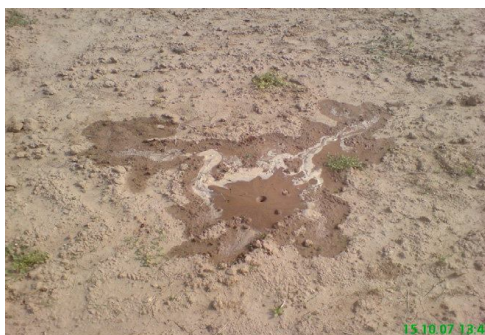
شکل 22- نمونه‌ای از مشکل پدید آمده در یک واحد آبیاری زیرسطحی به دلیل آبیاری اولیه با فشار کارکرد بالا (رودریگوئز سینوباس، 2015)
