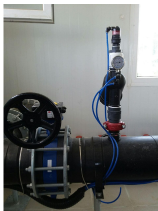
شکل 28- ادوات پایش و کنترل فشار در ایستگاه کنترل مرکزی یک سامانه آبیاری قطره‌ای زیرسطحی در منطقه بوئین زهرا (یوسف گمرکچی، 1398)
